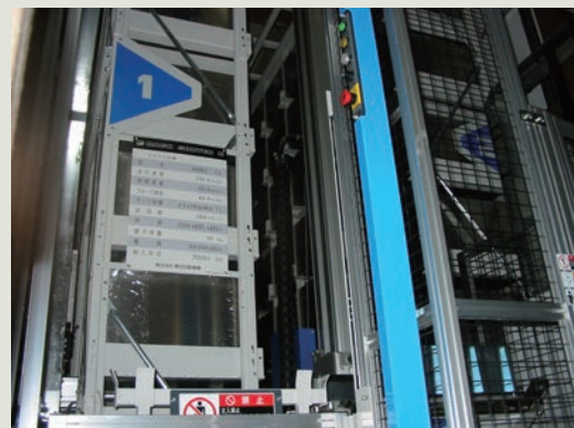
Rack Sorter B (ユニット式バケット用自動倉庫)
